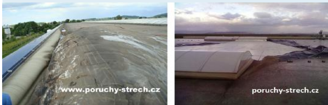
Foto 1 a 2 : havárie střešy vlivem větru 5, resp. 4 roky po realizaci (archiv autora)
